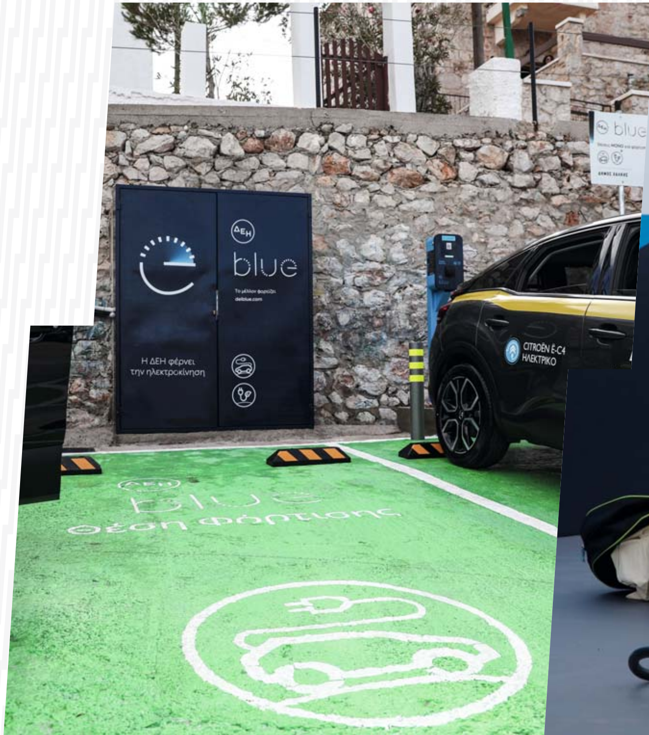
DEI Blue charging point in Halki
