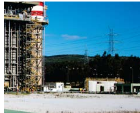
Φυσικό αέριο, μονάδα V Αλιβερίου
