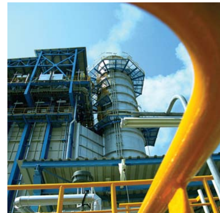
Φυσικό αέριο - Μονάδα V, Λαύριο
