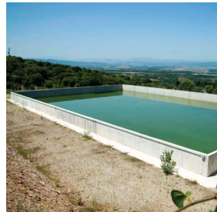
Νέα Δεξαμενή Ύδρευσης στη Παλιουριά του Δήμου Δεσκάτης Γρεβενών
