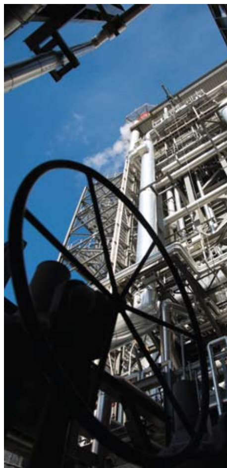
Φυσικό αέριο - Μονάδα V Μεγαλόπολη
