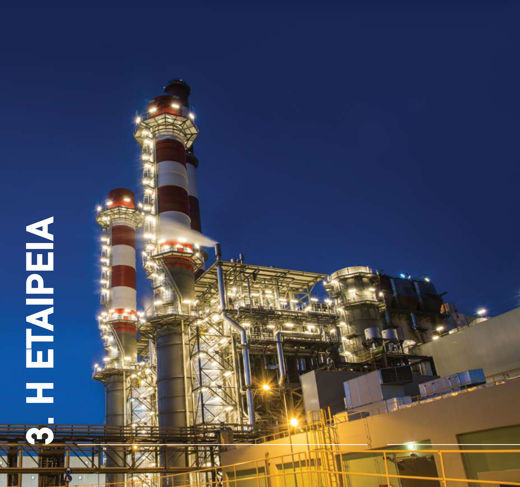
Φυσικό αέριο - Μονάδα V - Μεγαλόπολη
